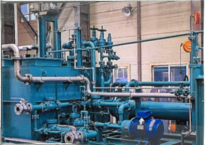
LUBE OIL UNIT 6000L×2400W×3510H 重量 : EMPTY 6,950kg OPERATING 9,706kg
