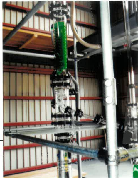
▲ 装置全体 (一部)
